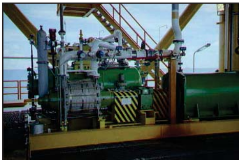
NASH 2BG Kompressor auf einer Offshore-Bohrplattform.
