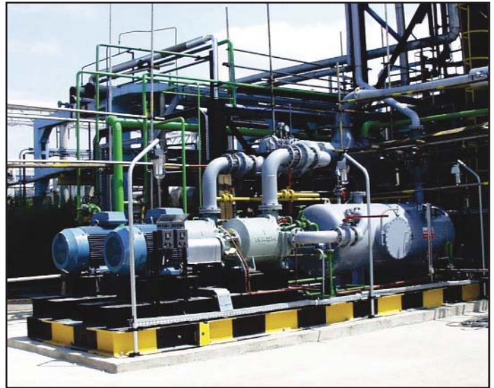
Duplex-Vakuumsystem in einer Destillationskolonne für Rohöl
